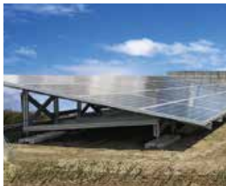
野立て（NK アンカー）
